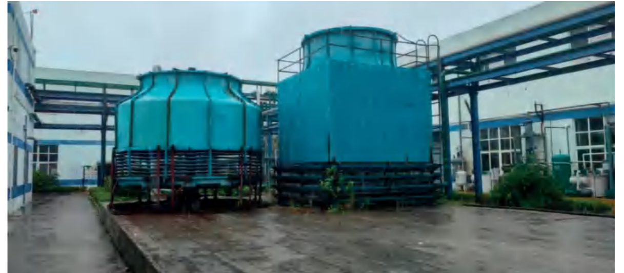
循环水冷却系统
